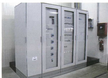
Quadro generale del piano semi interrato con scomparto logica e schede allarme
