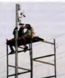
Installazione di una telecamera e ponte radio
