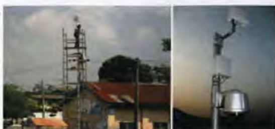
Installazione in un incrocio
